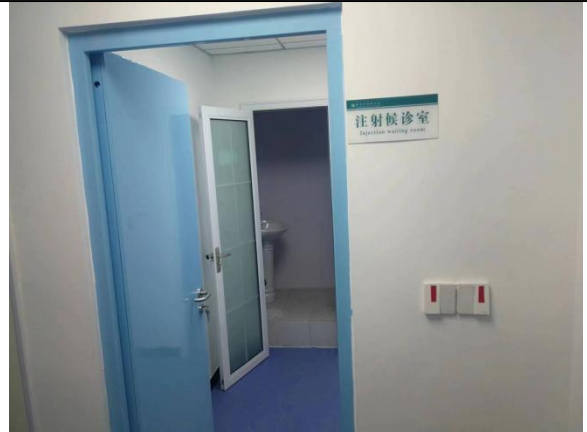
注射后候诊室
