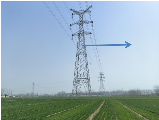
顺林线/柴林III线双回线路110#~111#杆塔西南侧 衰减
