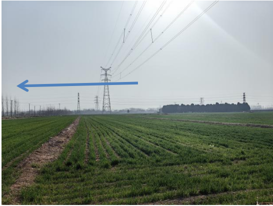
桥顺线/柴林III线双回线路25#~26#杆塔西侧衰减
