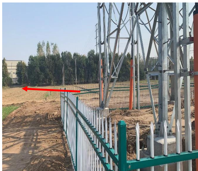
220kV畔城站~110kV畔莘线01号/110kV畔西线01号塔双回电缆南侧衰减
