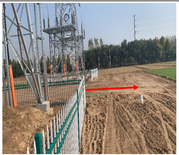
220kV畔城站~110kV畔寨线01号/110kV岳畔线103号塔双回电缆北侧衰减
