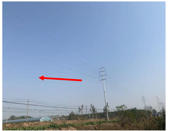
110kV畔范线08号~09号/110kV畔郑线08号~09号双回架空线路北侧衰减
